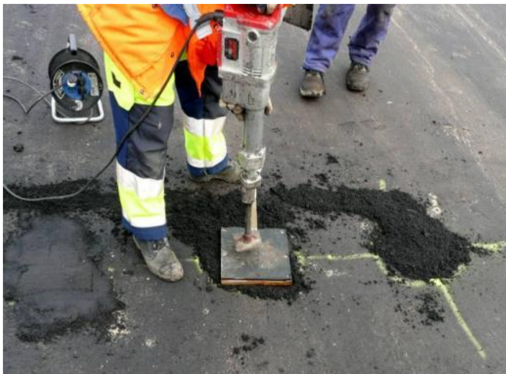
Fotografia 6 Pokrycie zainstalowanych czujników (ACG) warstwą z AP AF
